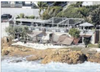
Sous le restaurant Cher Pech à Barlicaggi, sur la route des Sanguinaires à Ajaccio, la palissade et les tonnelles n'ont pas résisté à l'assaut des vagues.
