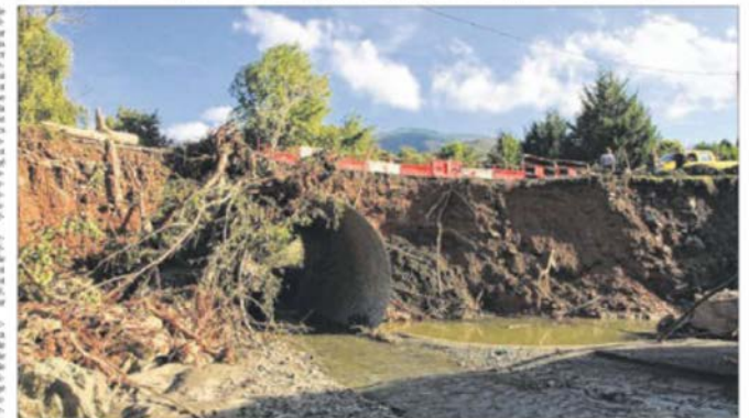
La crue a été accentuée par un bouchon de végétation qui, en défilant, a rongé la route, détruit un pont, un chemin d'accès et le chalet familial des Leca, construit par leur aïeul.
